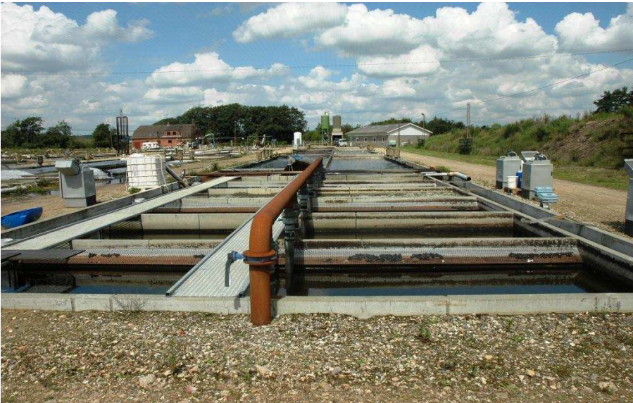
Abb. 2: Eine dänische Modellfischzucht Typs 3. Das Bild zeigt eine von vier parallelen Anlagen. Im Bildvordergrund befinden sich die Biofilter-Sektionen, die mit darauf folgenden Fließkanälen verbunden sind. Es wird ca. 5 l/s Frischwasser zugeführt. Das Wasser im System wird mit Hilfe von Airliften in der Größenordnung von 400-600 l/s bewegt.
